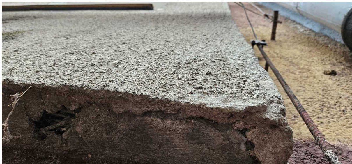
Rys. 4. Fragment spękaną obrzutki w okolicy cokołu – widoczna suprema.
