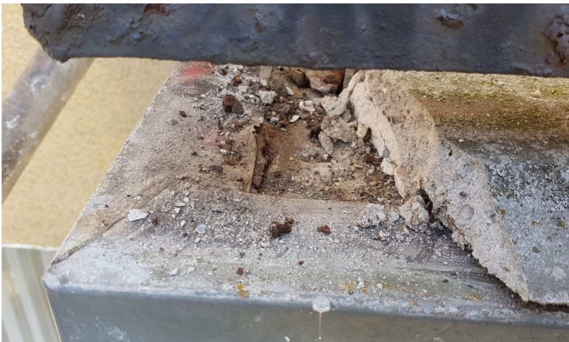
Fot. 5. Widok naroża płyty balkonowej osłoniętego jastrychem niskiej jakości
